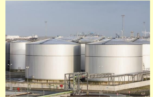
Резервуары и емкости
